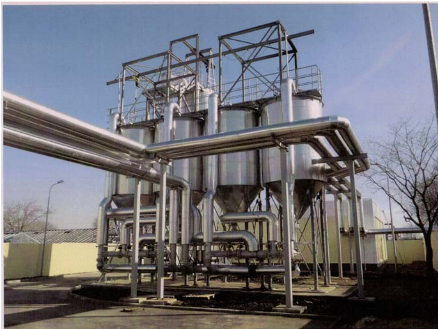
Abbildung 5: SILOXA-Gasreinigung Kläranlage Moskau 5.000 m 3 /h.
